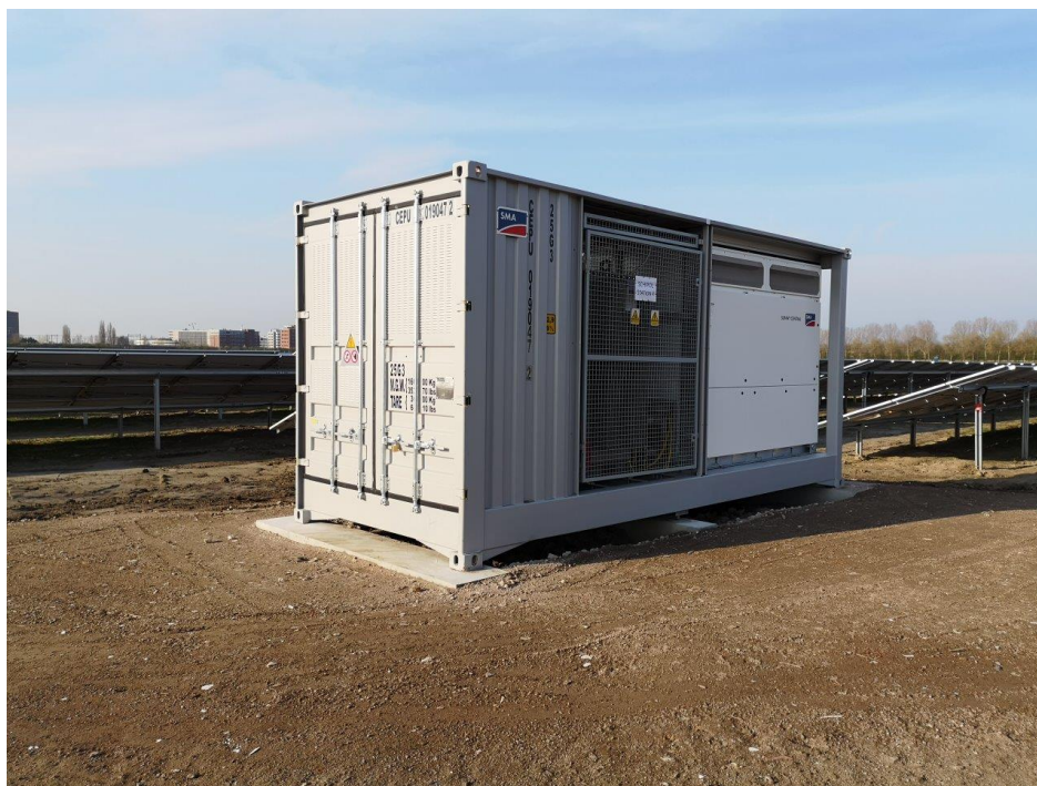
Figura 9 Inverter Power Station installata nel parco fotovoltaico
