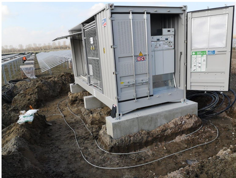
Figura 11 Inverter Power Station con installazione di cavo di messa a terra
